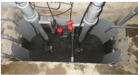
中継ポンプ槽・運転前
