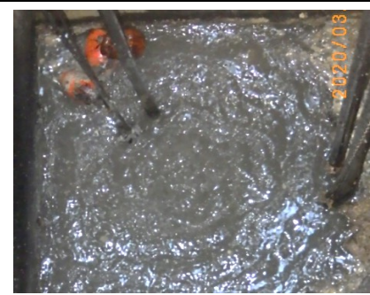
流入ポンプ槽
