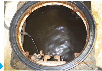
ハイブリッドシステム 設置後1ヶ月
