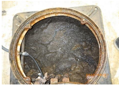
好気処理槽 脱臭システム設置前
