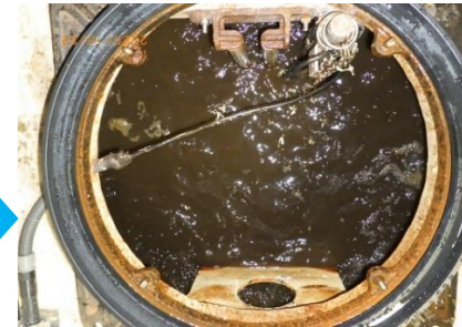
ハイブリッドシステム 設置後1ヶ月
