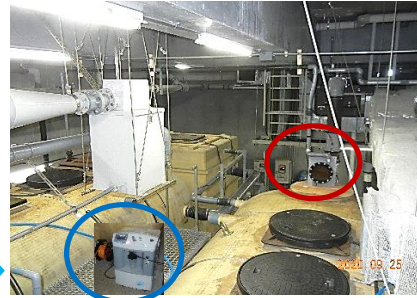
ハイブリッドシステム 脱臭システム設置後
