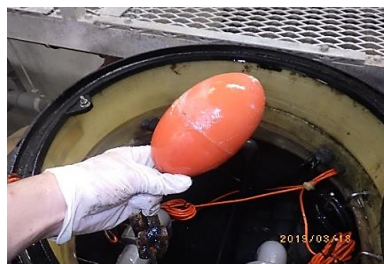
流入ポンプ槽
