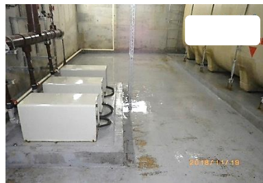
dsp処理槽室
