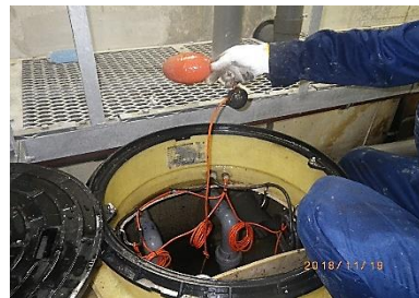
放流ポンプ槽
