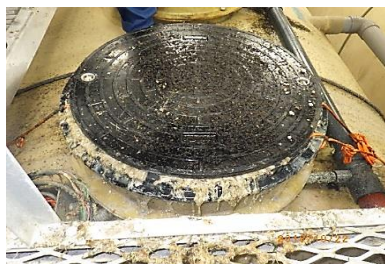
流入ポンプ槽
