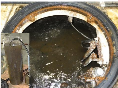
②好気処理槽：SV:80% 汚泥引抜寸前
