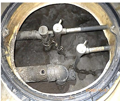
③沈殿槽、スカム堆積で引抜待ったなし
