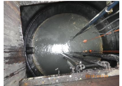
油脂ゼロポンプ槽で引抜ゼロ実現
