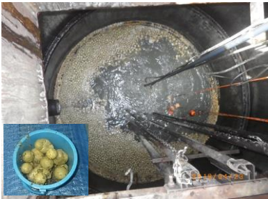
①中継ポンプ槽に多量の油脂堆積
