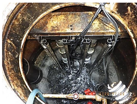
油脂ゼロポンプ槽 に改修（特許）
