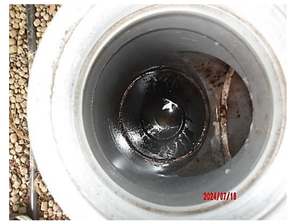
土壌脱臭装置、埋設臭気配管内の水溜まり
