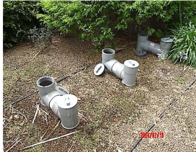
土壌脱臭装置、埋設設置箇所
