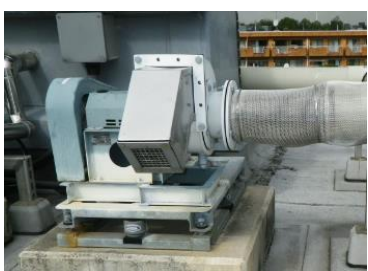
臭気ファン接続部、カラス対策
