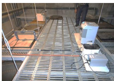
ハイブリッド・システム付加設置
