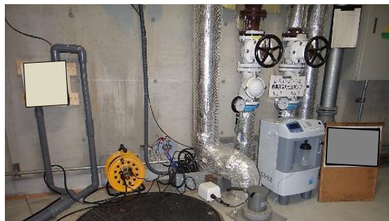
都内除害施設に採用
