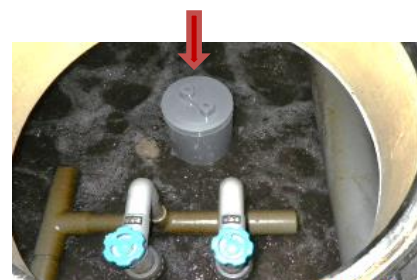
汚泥引抜き開口部を掃除口で閉鎖
