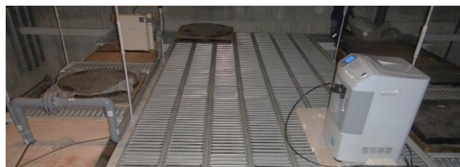
DSP・HVシステム設置状況
