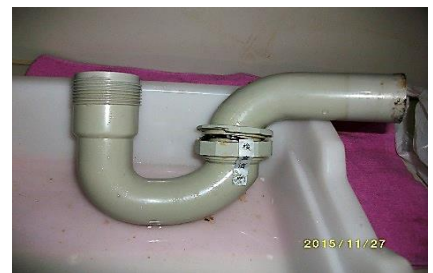
排水トラップの損傷
