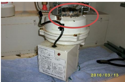
本体の腐食による漏水
