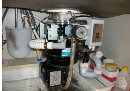
モーター故障により作動せず
