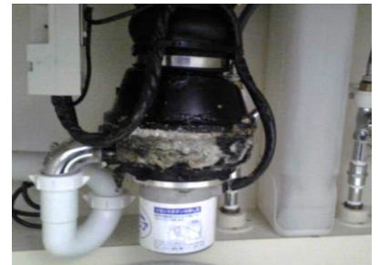
本体の腐食による漏水
