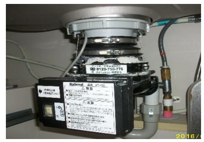
本体の腐食による漏水
