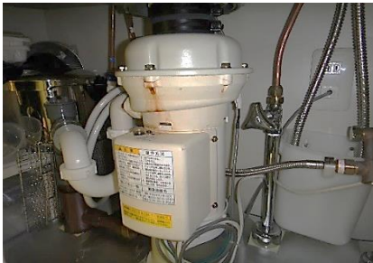
水漏れ・漏電
