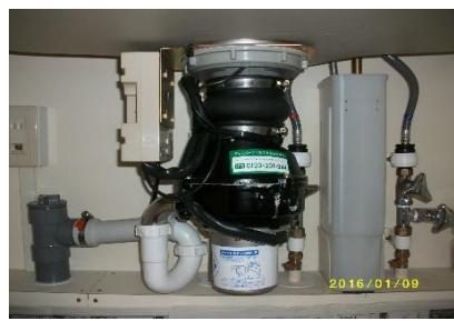
本体の腐食による漏水
