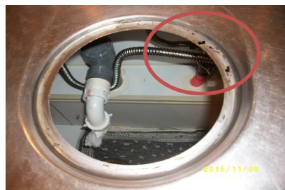
腐食によりシンクに穴？
