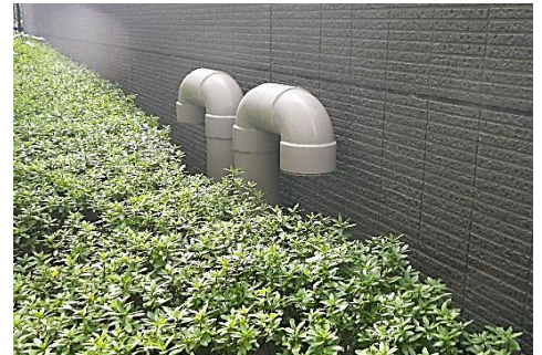
屋外給排気口
