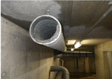
管理スペース給気口
