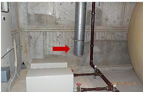
管理スペース給気口
