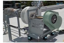
屋上臭気ファン 160m 3 /h
