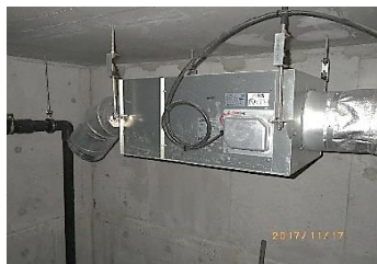
是正前 換気・排気ファン
