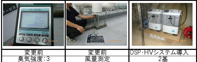
変更前臭気強度:3 変更前風量測定 DSP・HVシステム導入2基
